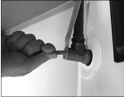
Figure 38 - Soupape de décharge DST
